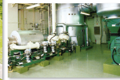
アイソトープ廃棄物の焼却処理設備
